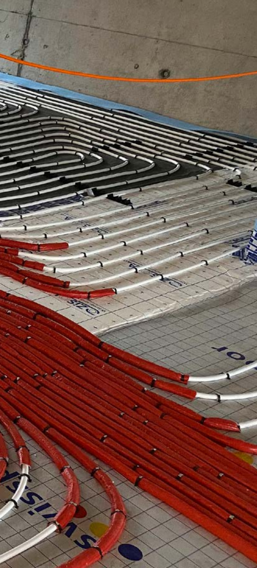
Referenzanlage: Tecton Abdichtungen AG, Ziel: Maximieren der Energieeffizienz bei Vorlauftemperatur 30 °C, Auftrag: Heizlastberechnung, FBH-Planung. Hier im Bild: Deckendurchführung vom UG her.
